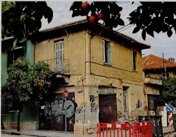
Προσφυγικό διώροφο σπίτι με καταστράφη στο ισόγειο στη Νίκαια, Βοσπόρου και Δημητρίου Καρακουλούξη 34.
